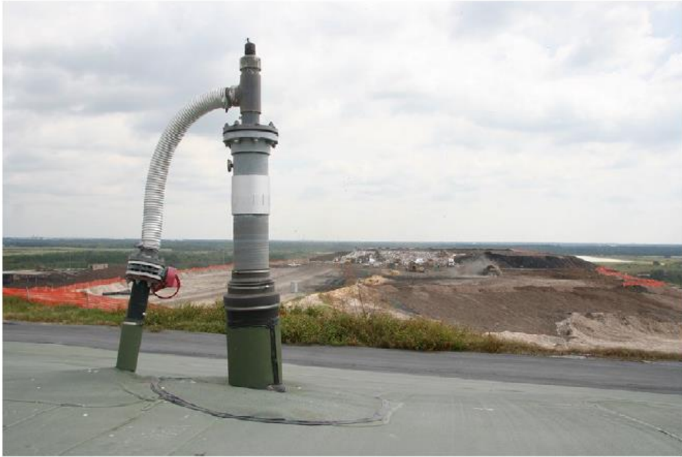
Fig. 2.5: Extremo superior del sistema de captación de gas (Townsed, 2015)
