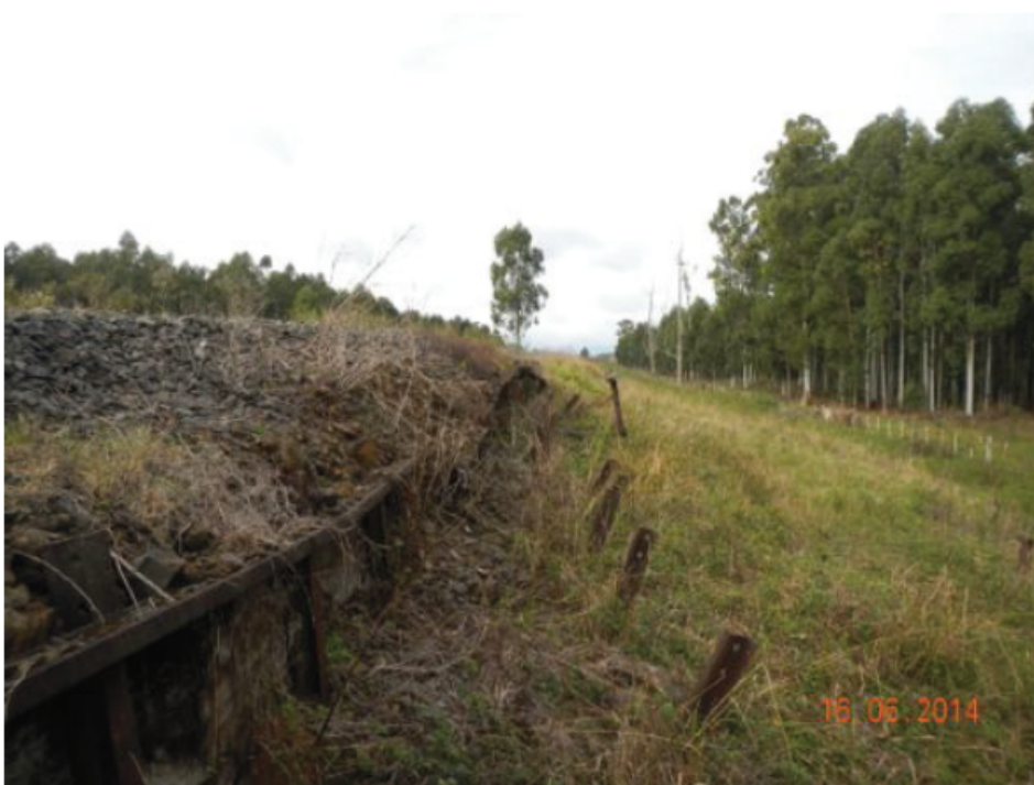
Figura 0.4: PK 36+500. Defensas Vencidas
