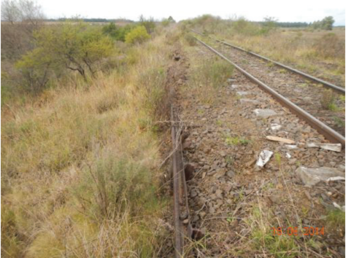
Figura 0.1: PK 36+500 Defensas realizadas. Árboles inclinados.
