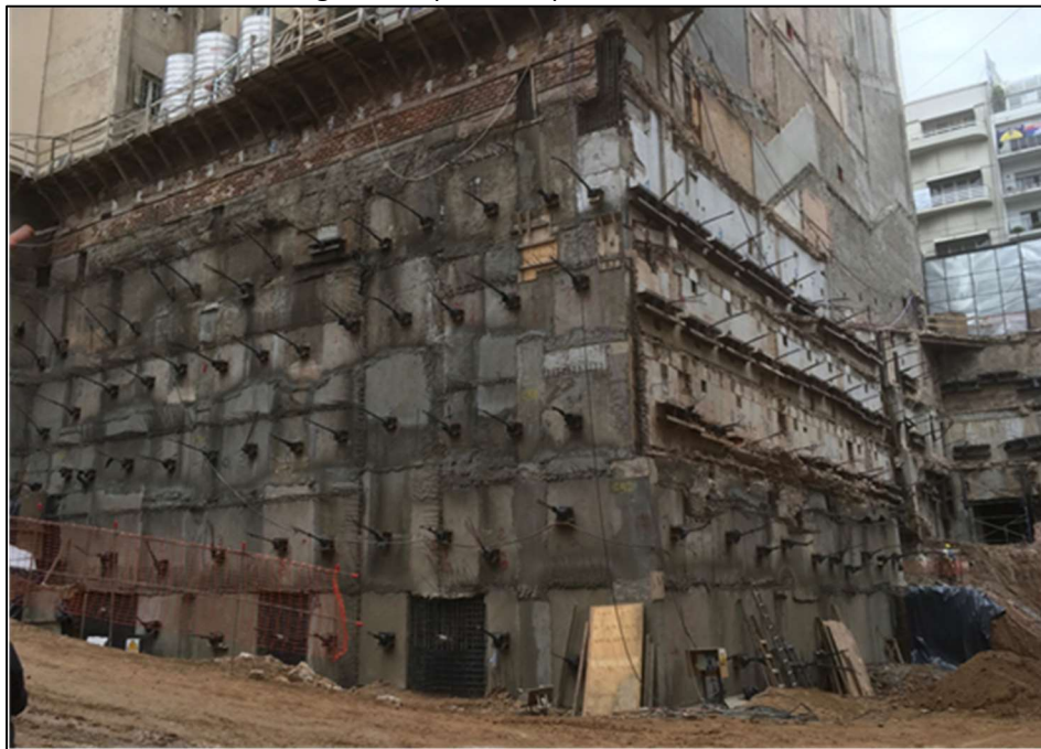
Figura 2 Se observan las 5 líneas de anclajes que se cruzan perpendicularmente en la esquina del submural.
