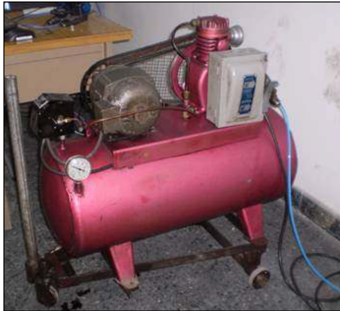
Fig. 2. Vista del compresor.
