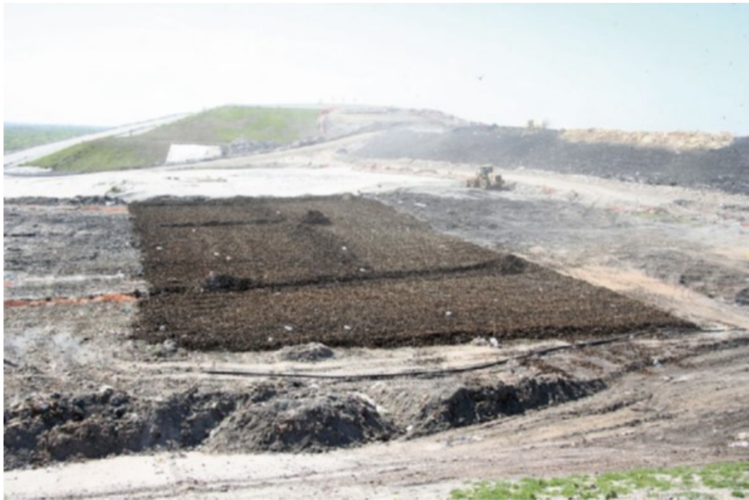
Figura 3.7: Instalación de un sistema de adición de agua por superficie de drenaje (Townsend et al., 2015).
