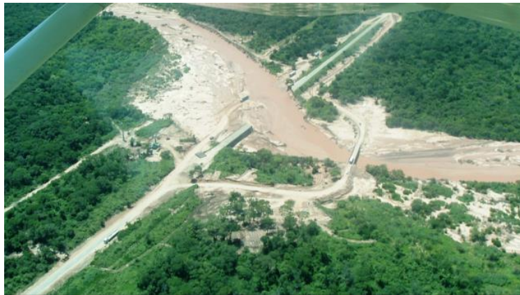
En la imagen puede observarse como el ángulo cerrado sobre margen izquierda provocó que la erosión se concentrara en esa margen, con la pérdida total del estribo y la caída del puente.
