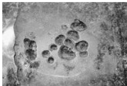
Figura 1.12: Corrosión localizada por acción bacteriana (MIC)
