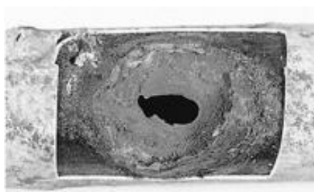
Figura 1.10: Corrosión localizada con perforación por descarga desde la cañería de corrientes vagabundas.
