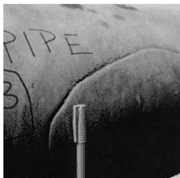
Figura 1.11: Corrosión localizada sobre daño mecánico
